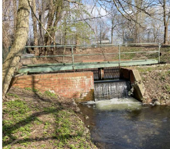
Wehr am Zulauf Nonnengraben
