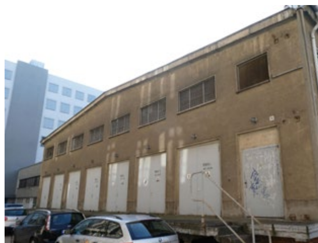
Abb. 53 Transformatorentore am Haus 25
