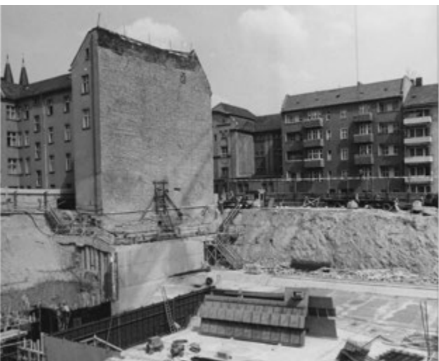
Abb. 96 Erd- und Sonderbau in Vorbereitung der Errichtung von Haus 8/9, links Haus 6 (Ausschnitt) [BStU]
